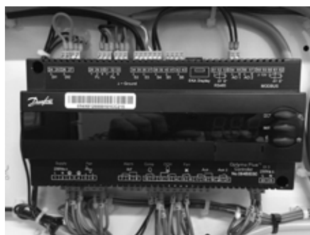
Bilde 3: Normal kabling
