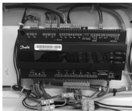
Bilde 4: Midlertidig kabling
